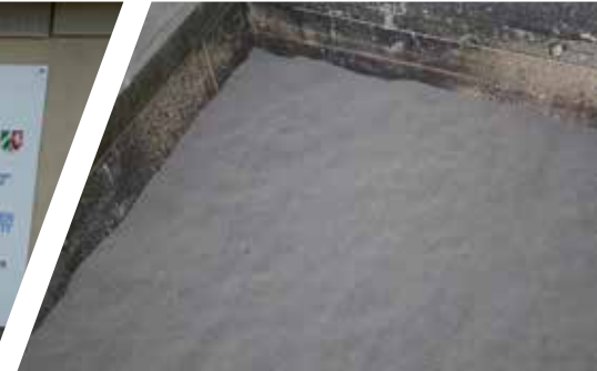
Filterbett bei abgesenktem Wasserspiegel
